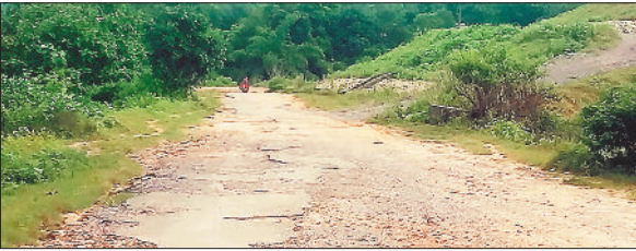
बालको से रोगबहरी जाने वाली जर्जर सड़क।
